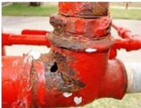
Figura 1. Efectos de la corrosión
