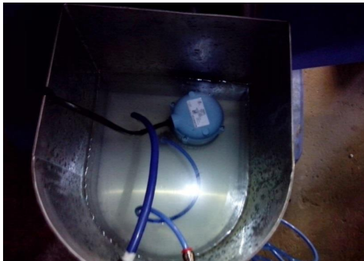
Figura 39. Bomba del sistema de enfriamiento
