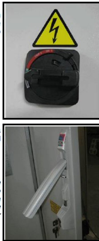
Figura 18. Dispositivos de seguridad en el armario eléctrico
