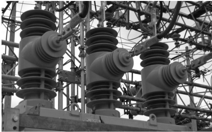
Figura 34. Recloser de un circuito de distribución
