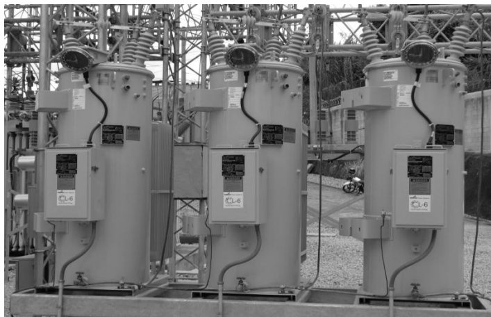
Figura 37. Reguladores de Voltaje de 13,8 kV
