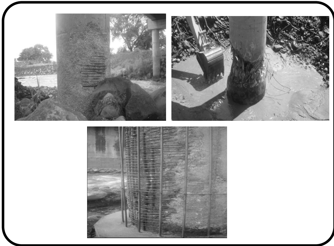
Figura 6. Daños en puentes de concreto reforzado en pilas de apoyo carretera CA2 red vial nacional Guatemala
