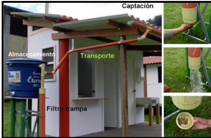
Figura 11. Tanques instalados sobre el nivel del suelo
