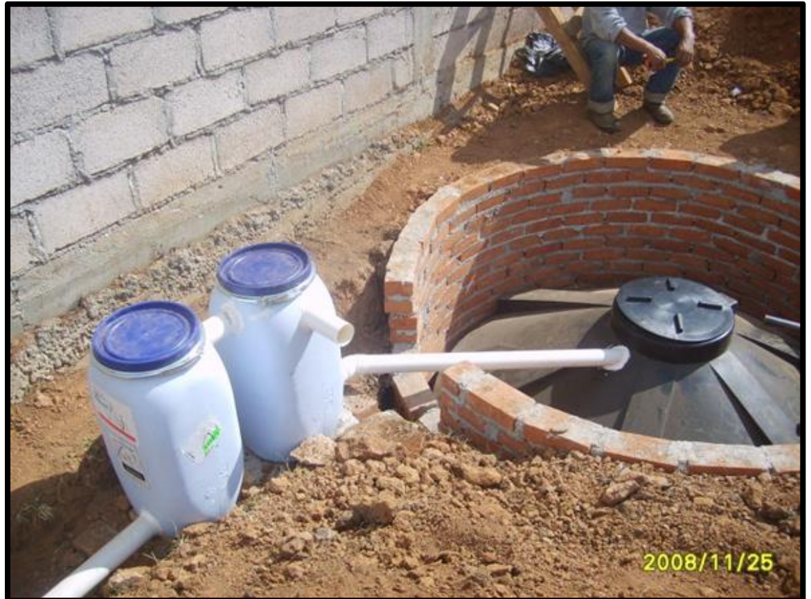
Figura 12. Tanques instalados debajo del nivel del suelo
