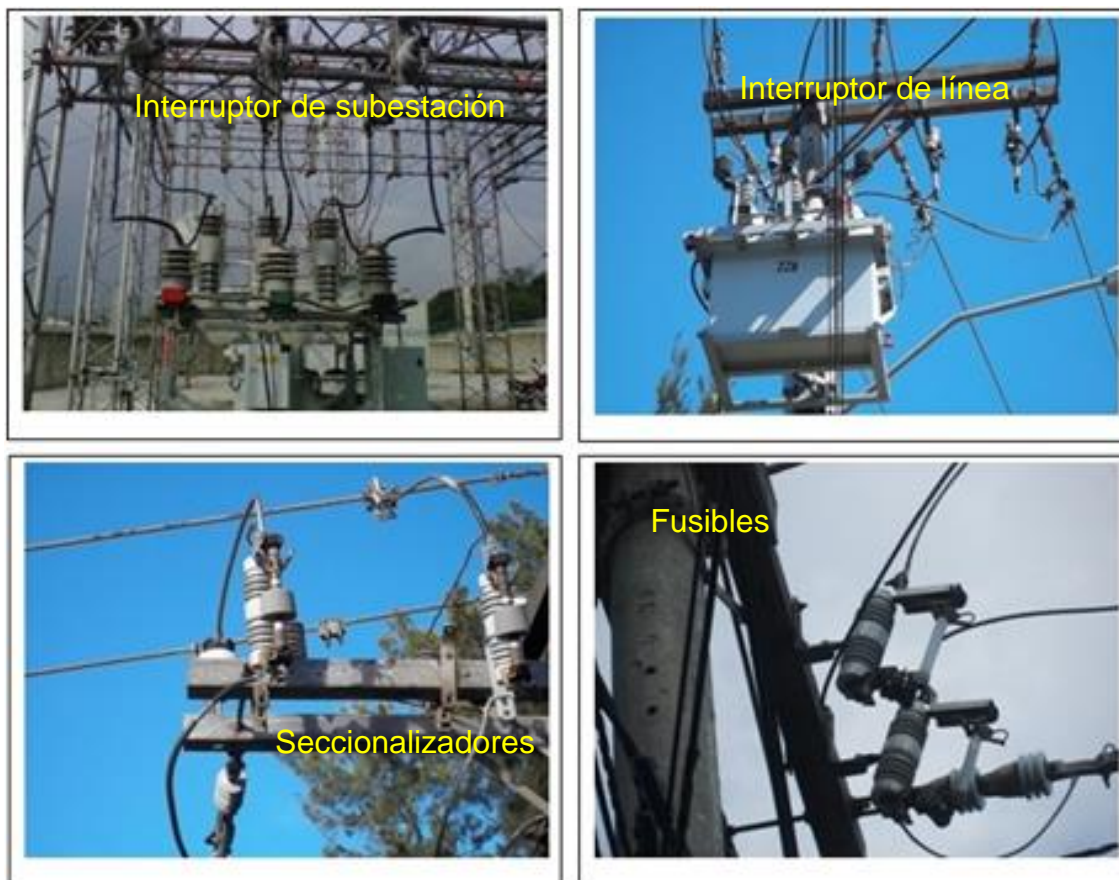
Figura 3. Dispositivos de protección utilizados actualmente en EEGSA
