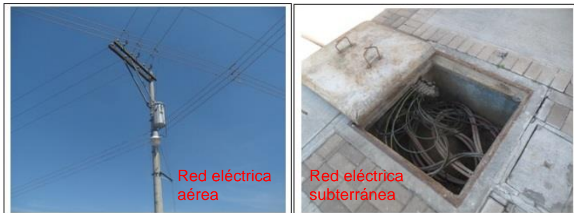
Figura 6. Tipos de construcción de la red de distribución utilizados por EEGSA para distribuir energía eléctrica
