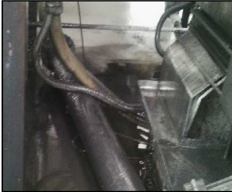
Figura 44. Fugas por mangueras rotas
