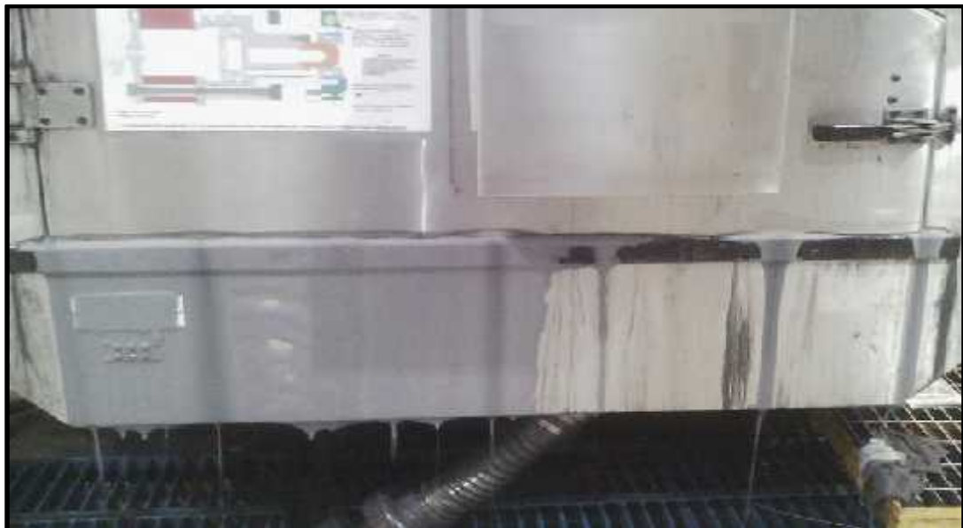
Figura 46. Fugas por generación de espuma
