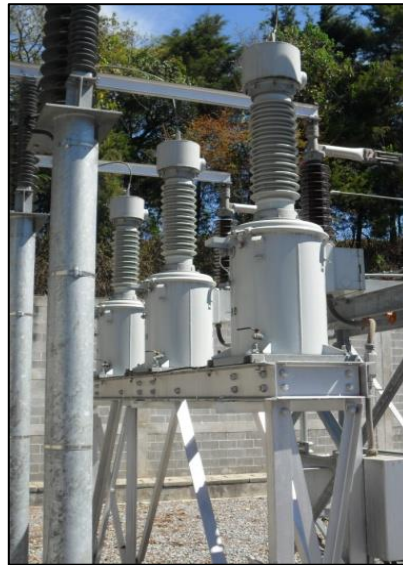
Figura 8. Transformador de potencia
