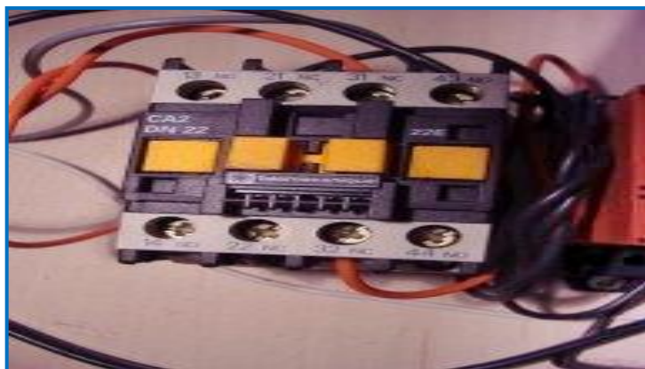
Figura 21. Contactor usado en un aire acondicionado
