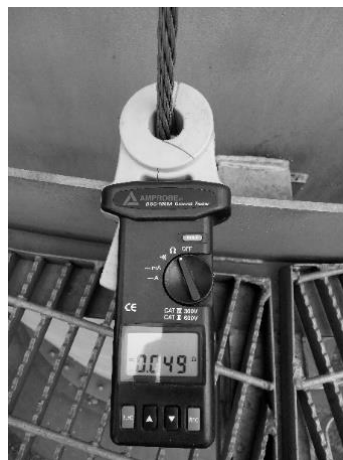
Figura 22. Medición de resistencia a tierra
