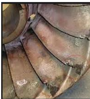
Figura 15. Daños ocasionados por cavitación en una turbina de vapor
