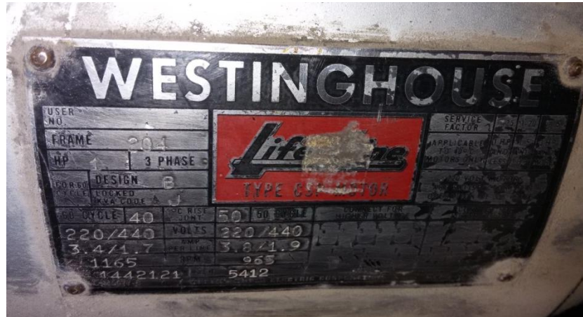
Figura 5. Placa motor de bomba hidráulica
