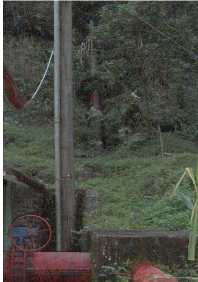
Figura 4. Tubería de presión
