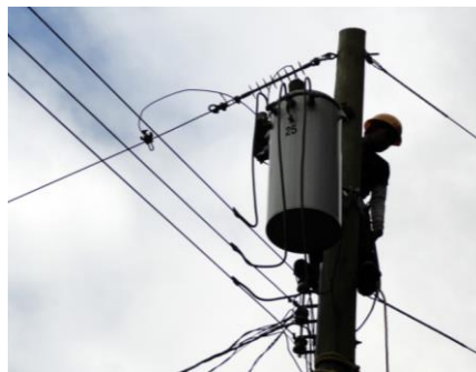
Figura 33. Transformador de distribución
