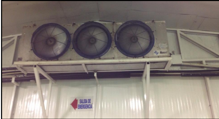
Figura 24. Vista de evaporadores interior de planta
