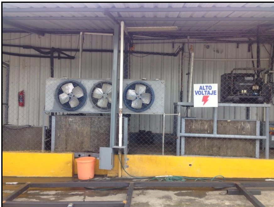
Figura 25. Vista de área de banco de condensadores actuales
