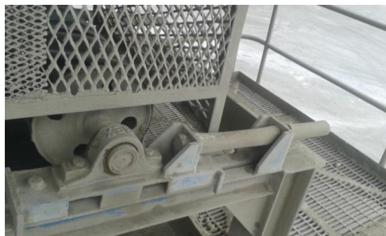
Figura 7. Sistema de tensión en el rodo de cola
