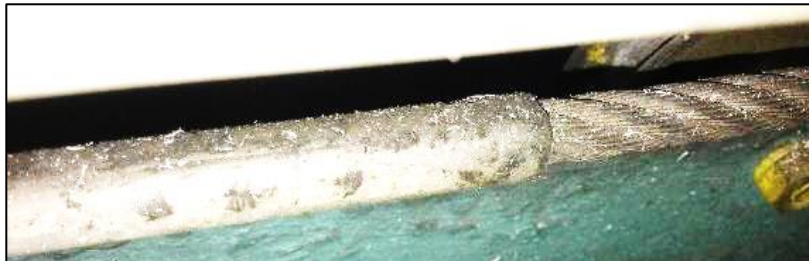
Figura 10. Cable sin revestimiento de caucho
