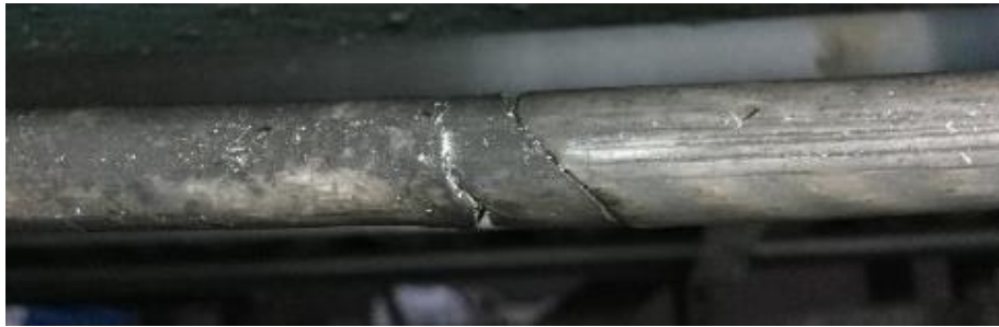
Figura 11. Rotura y soldadura de cable
