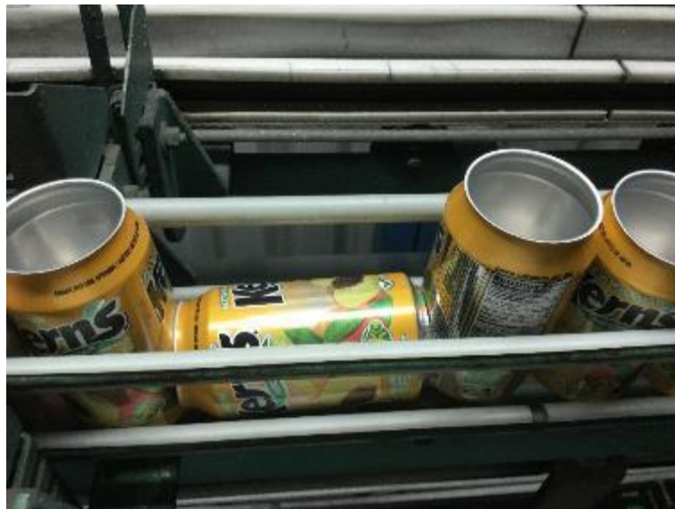
Figura 8. Envase caído en cable aéreo
