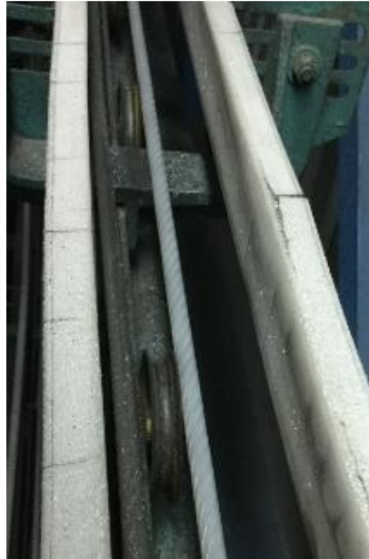
Figura 9. Cable fuera de poleas
