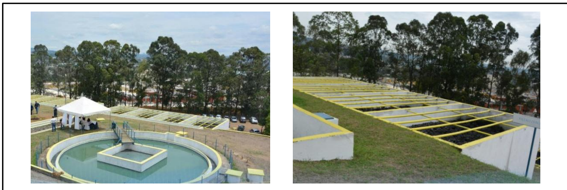
Figura 5. Tanque de sedimentación y filtros percoladores en planta Santa Isabel II, año 2018
