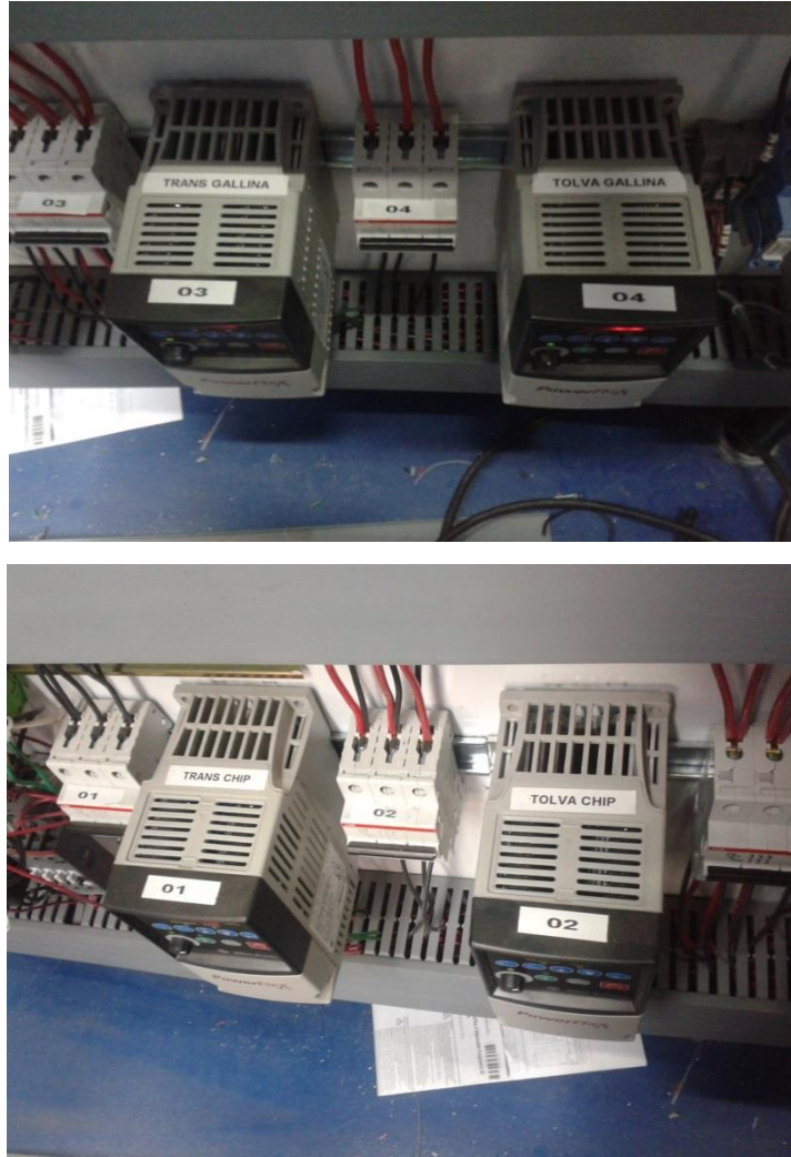
Figura 9. Variadores de alimentación de combustible
