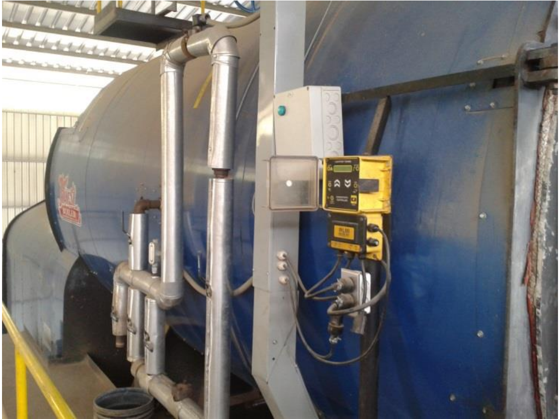
Figura 24. Sistema de control de purga automática
