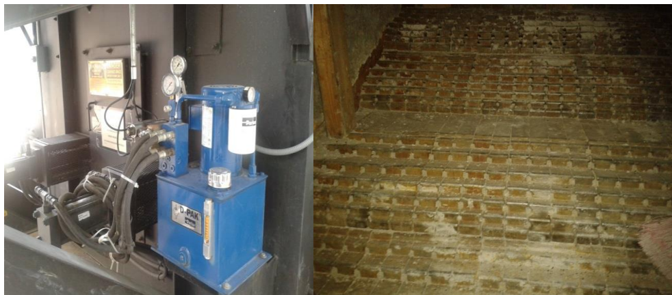
Figura 20. Sistema hidráulico y parrillas móviles
