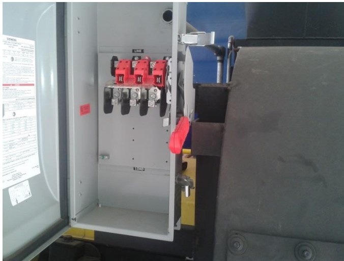
Figura 11. Alimentación eléctrica principal
