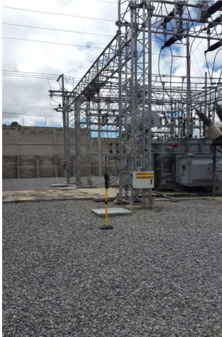
Figura 21. Medición campo magnético pÓrtico de entrada 69 kV
