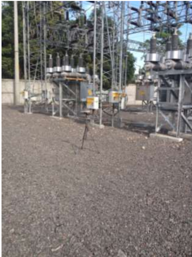
Figura 10. Medición campo eléctrico entrada línea 69 kV
