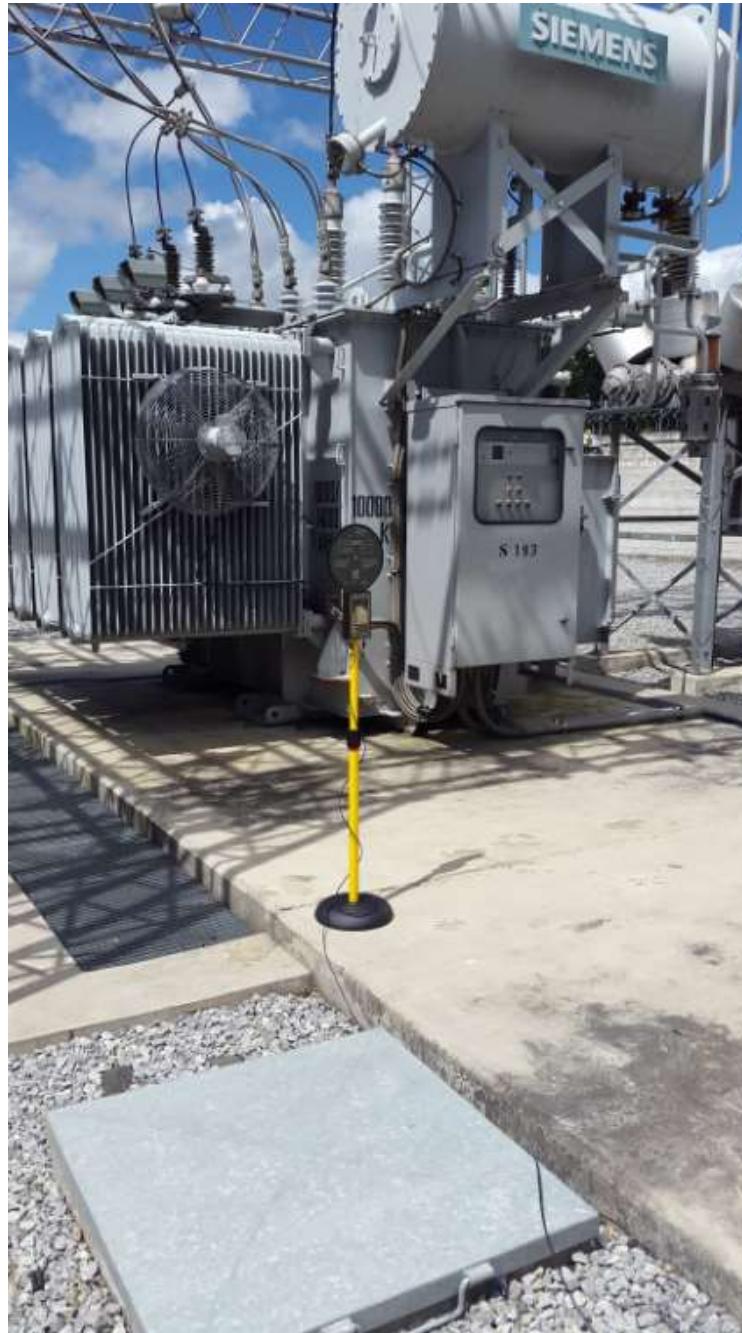
Figura 23. Medición campo magnético barra 13,8 kV
