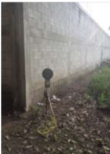
Figura 14. Medición campo magnético colindancia 2 subestación El Milagro
