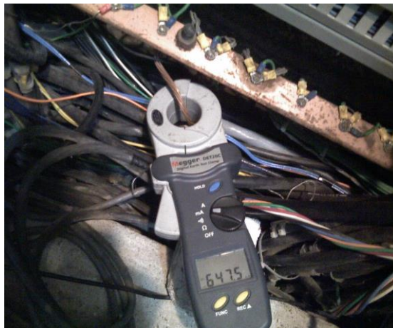
Figura 71. Barra equipotencial de tablero “Interruptor enlace 69 kV”
