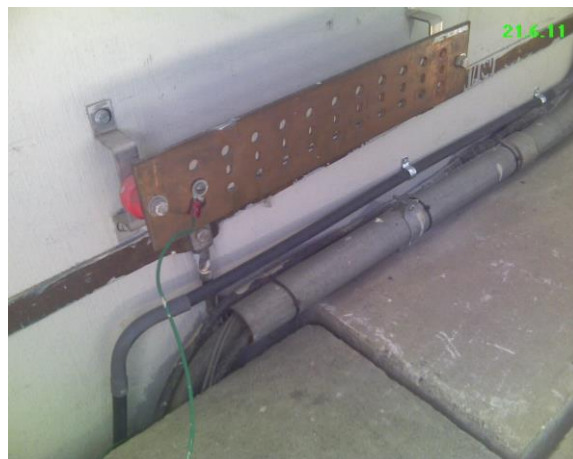
Figura 41. Barra equipotencial de la caseta “Siquinalá”
