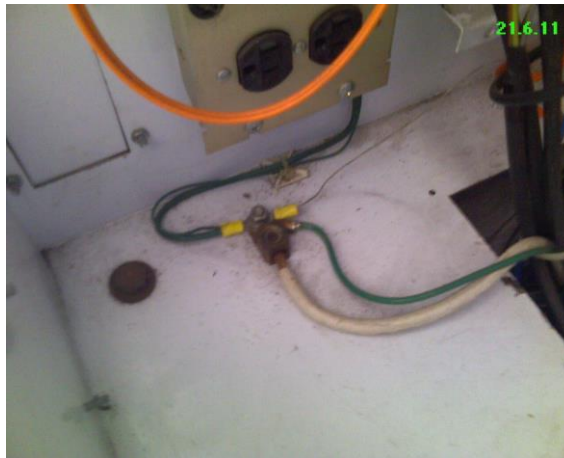
Figura 42. Puesta a tierra en tablero RTU Siquinalá-Guate sur
