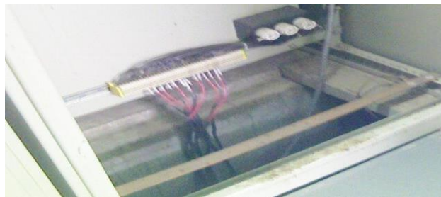
Figura 106. Barra equipotencial del tablero “MC Enlace”
