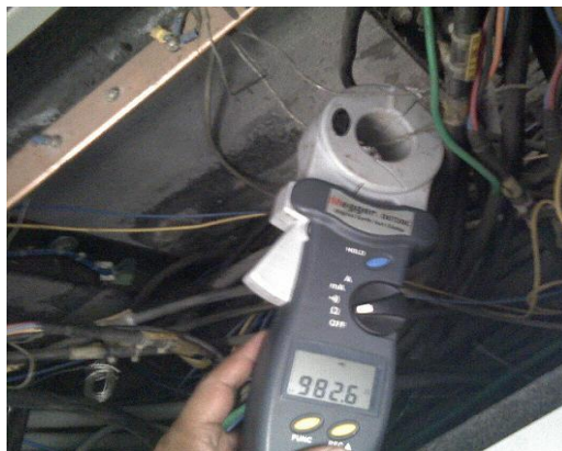
Figura 56. Blindajes de cables de señal en tablero “Jurún Marinalá”
