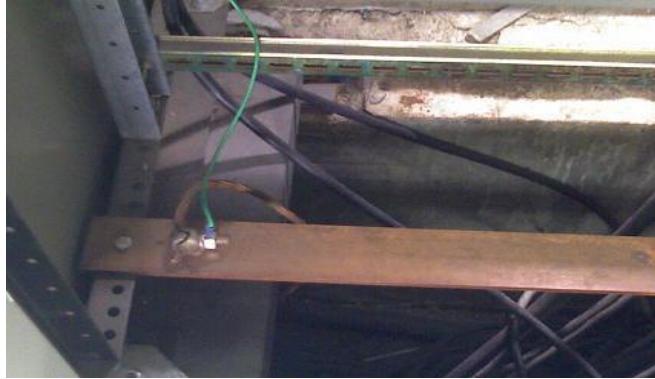
Figura 107. Barra equipotencial del tablero “MC Sidegua”
