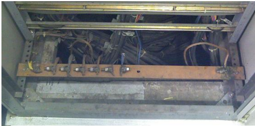
Figura 84. Barra equipotencial del tablero “BZ Interconexión 2”
