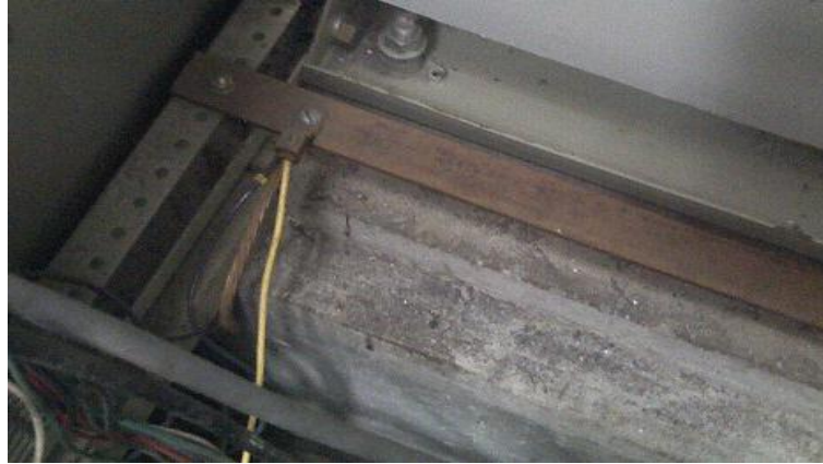
Figura 96. Barra equipotencial del tablero “PM Interconexión 1”
