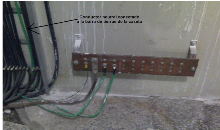
Figura 63. Barra equipotencial de caseta “Enlace 2 a 69 kV”
