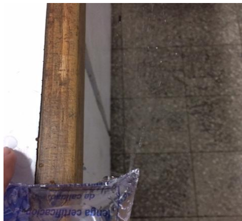
Figura 13. Fugas en producto terminado
