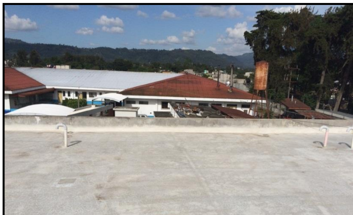
Figura 15. Ubicación para el sistema de calentadores solares
