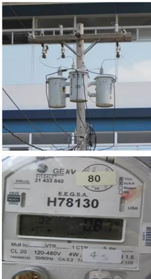
Figura 45. Banco de transformadores y contador edificio S-1
