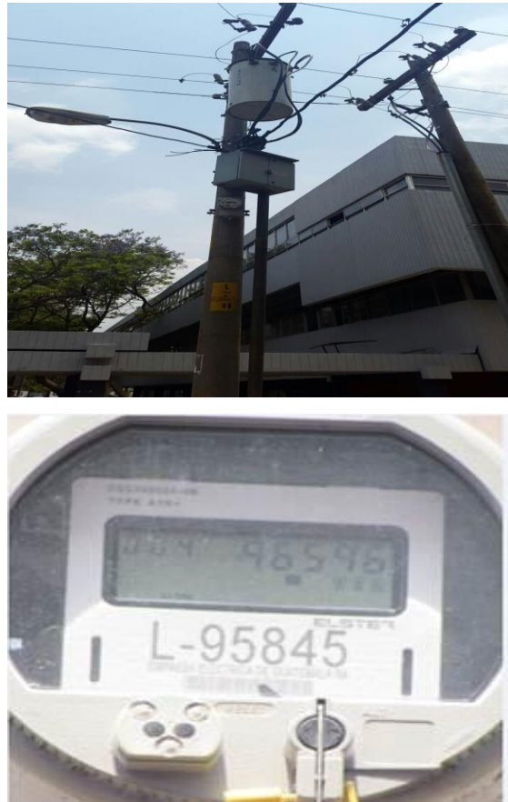
Figura 46. Banco de transformadores y contador edificio M-5
