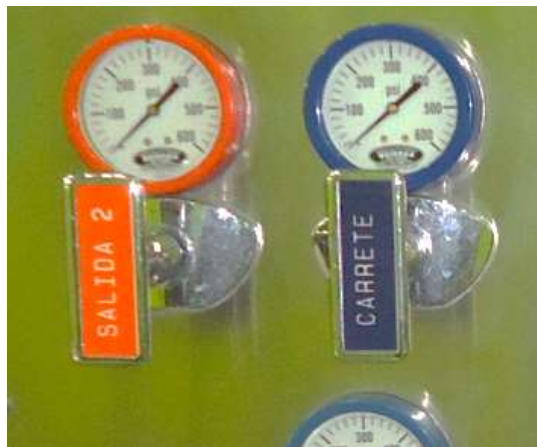
Figura 34. Manómetros de salida 2 y carrete
