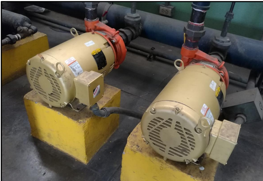
Figura 8. Sistema de bombeo de contención
