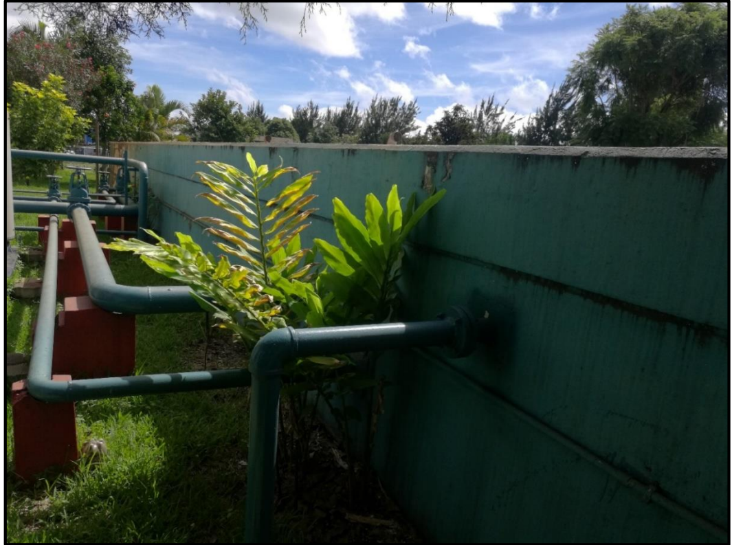
Figura 22. Cisterna o tanque de almacenamiento de agua
