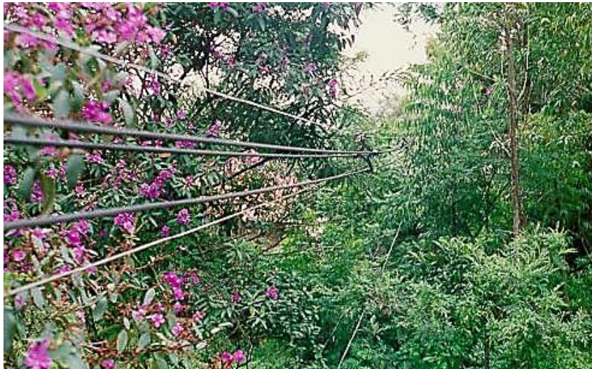
Figura 15. Red eléctrica compacta en contacto con ramas y árboles
