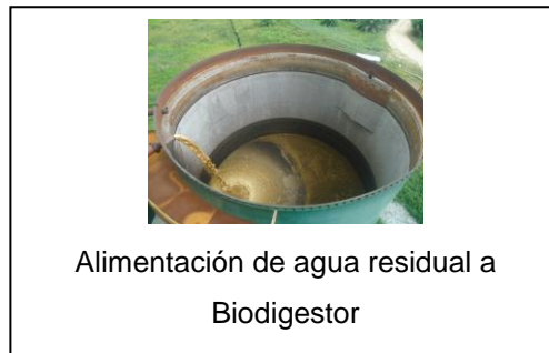
Figura 30. Alimentación de agua residual a Biodigestor
