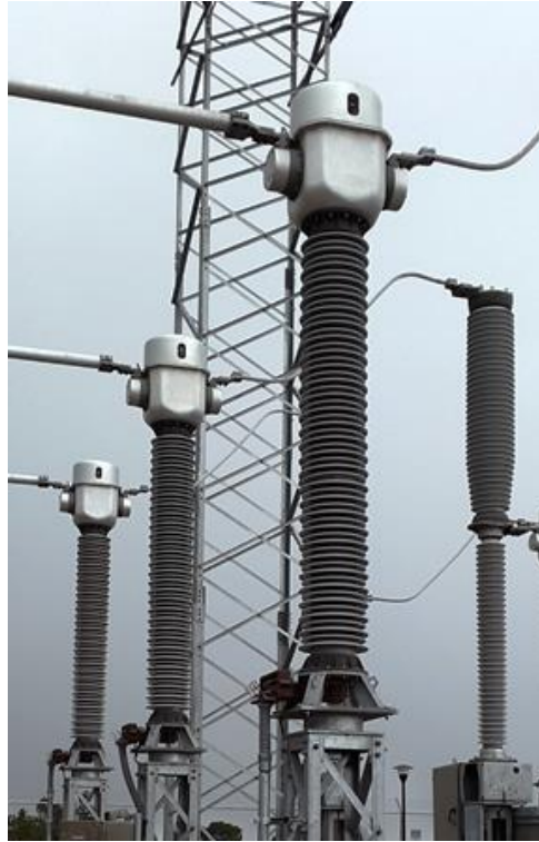
Figura 1. Transformadores de corriente de 230 kV
