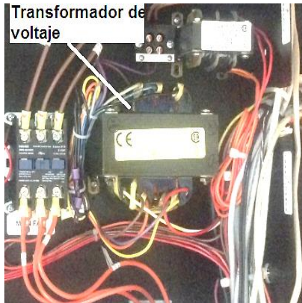
Figura 60. Transformador de voltaje
