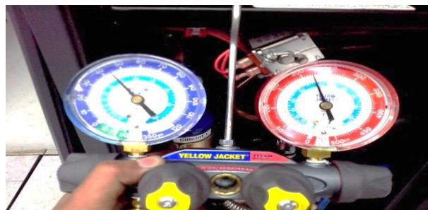
Figura 56. Manómetros para aire acondicionado
