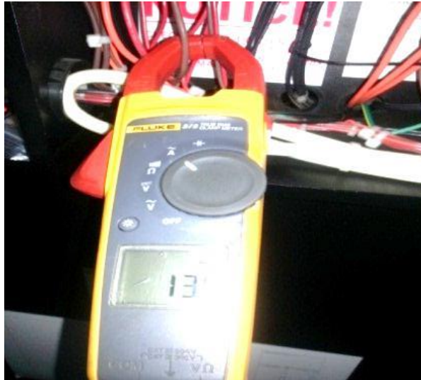
Figura 62. Medición de corriente del compresor
