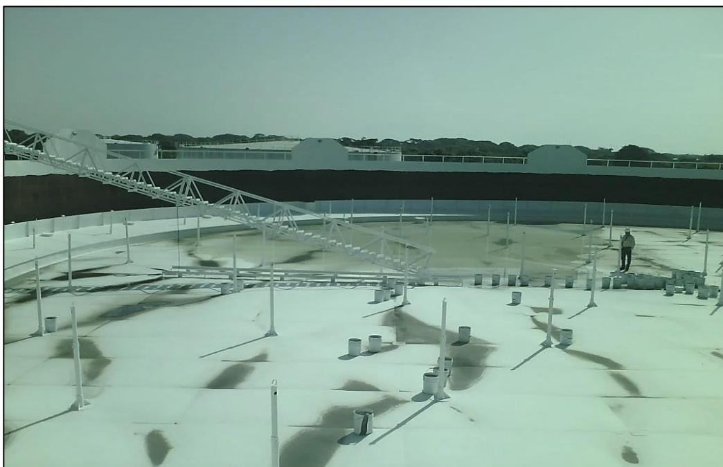
Figura 16. Techo flotante externo
