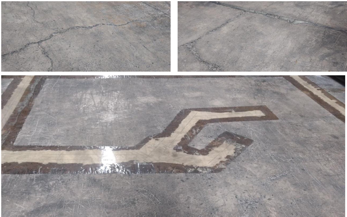
Figura 13. Imágenes de cimentación dañada y reparada
