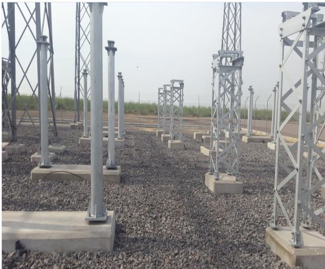
Figura 8. Patio de la subestación eléctrica 230 kv
