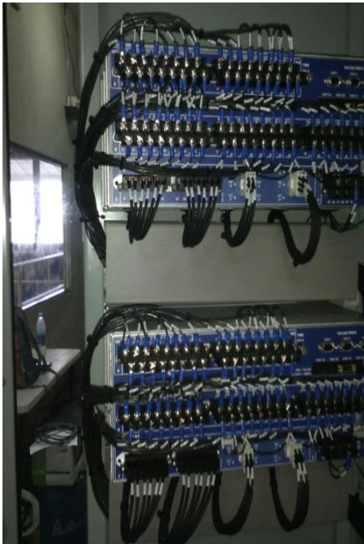
Figura 5. Bobinas de relevadores
