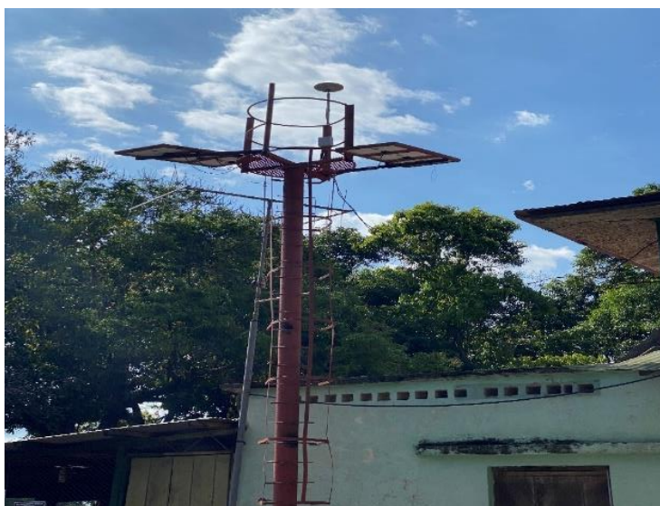
Figura 11. Torre para instalación de paneles solares
