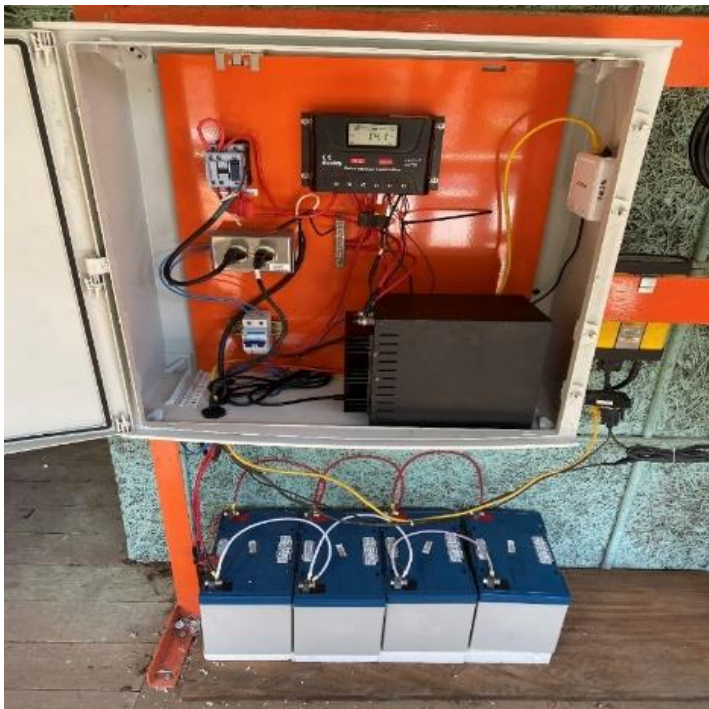
Figura 12. Equipo de regulación y carga de baterías
