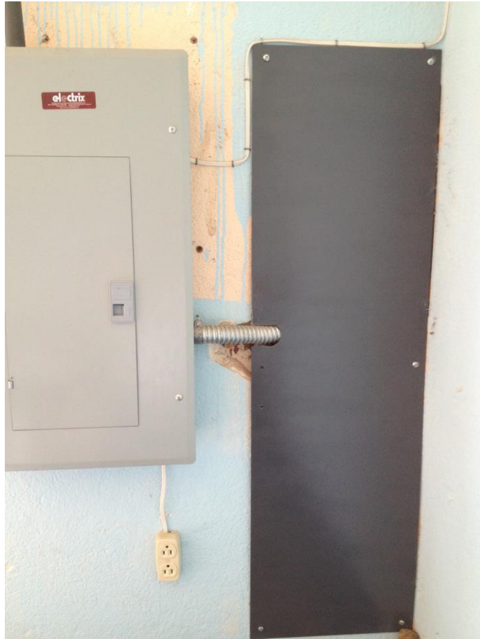
Figura 9. Tablero principal y entorno
