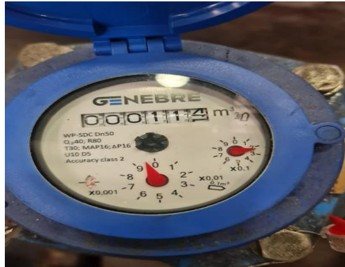
Figura 12. Contador instalado en el proceso de laminado
