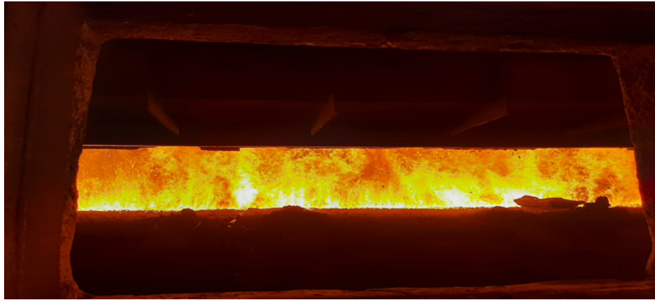
Figura 19. Combustión de bambú en el hogar de la caldera de vapor
