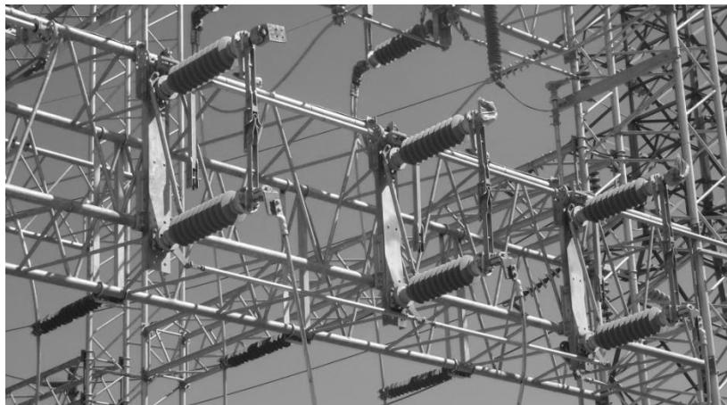
Figura 17. Seccionador de línea y barra marca Mesa
