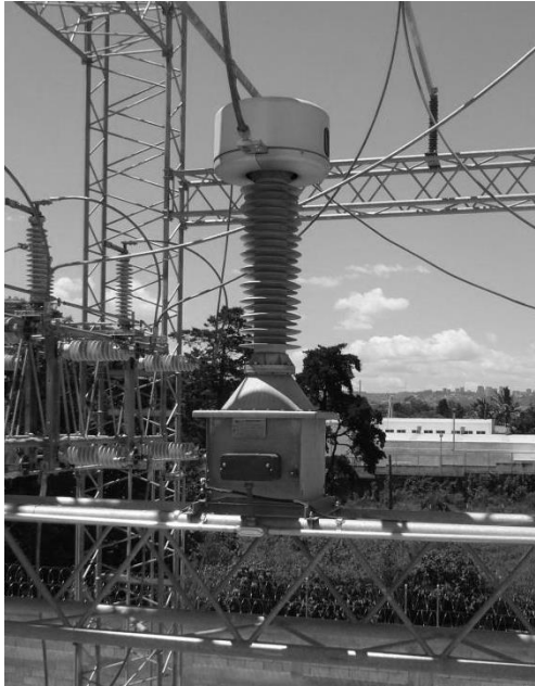
Figura 16. Transformador de potencial marca Artech
