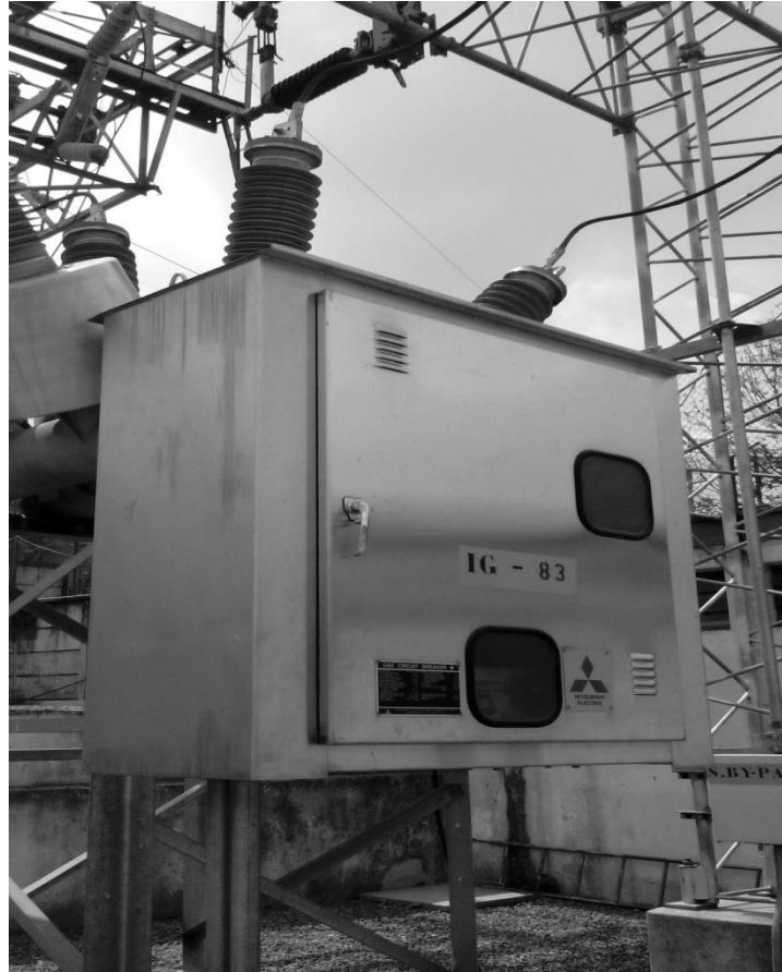
Figura 15. Interruptor de potencia subestación Antigua Guatemala
