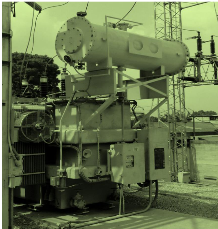
Figura 14. Transformador de potencia subestación Antigua
