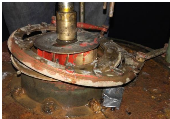
Figura 14. Eslabones y álabes dañados
