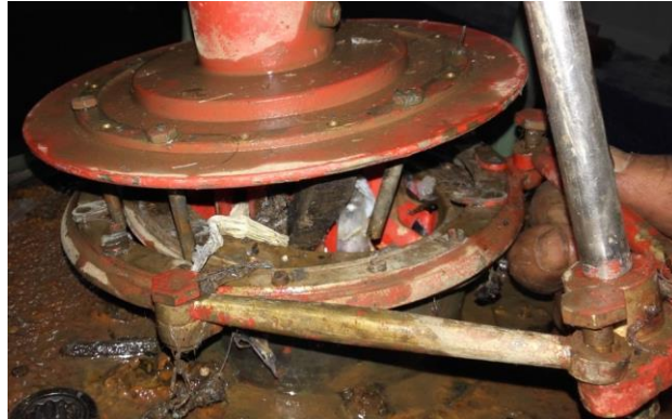
Figura 13. Distribuidor Fink dañado
