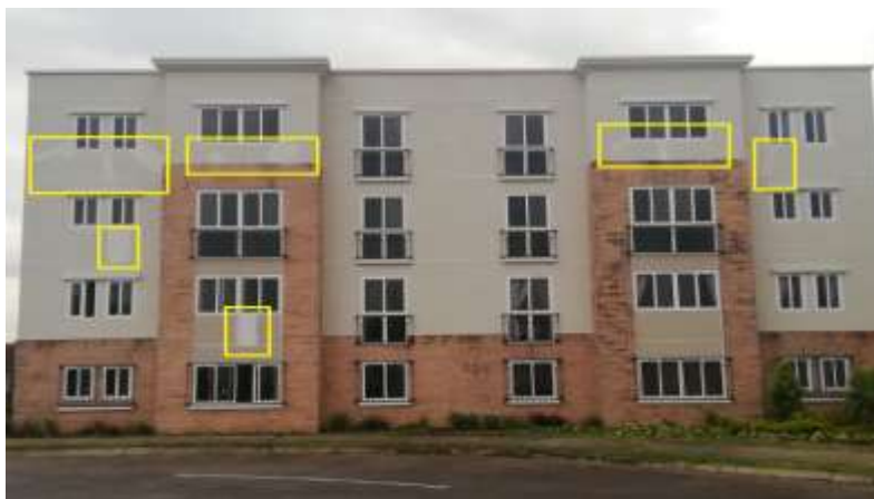
Figura 7. Fisuras formadas en el edificio en estudio
