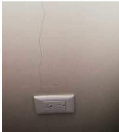
Figura 16. Fisura provocada en muros por instalaciones eléctricas
