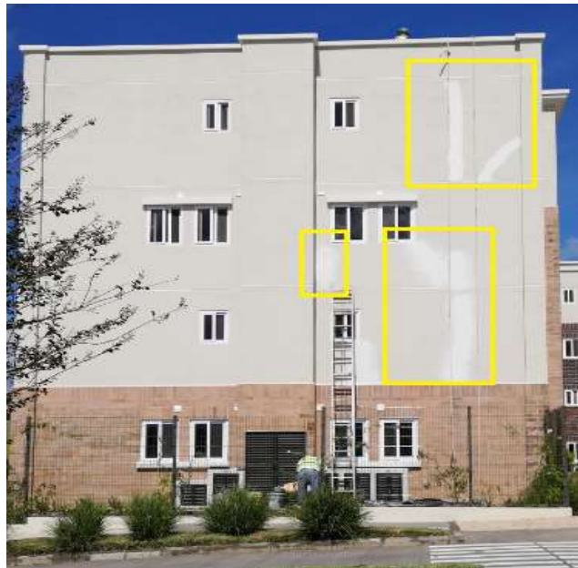
Figura 9. Fisuras formadas en el edificio en estudio
