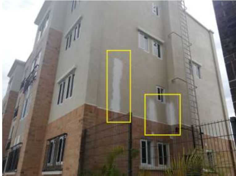
Figura 8. Fisuras formadas en el edificio en estudio
