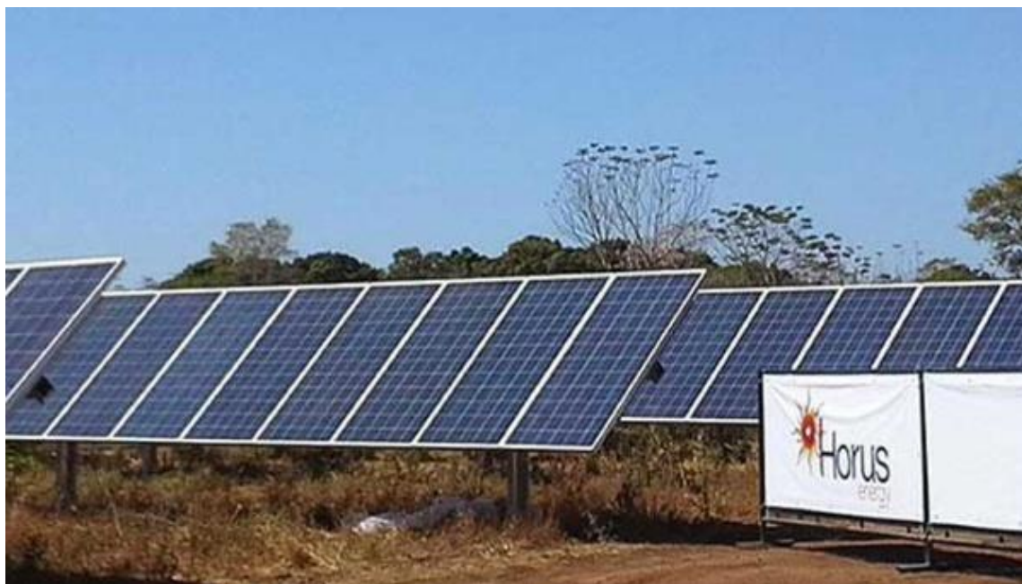
Figura 1. Planta solar fotovoltaica-Horus Guatemala
