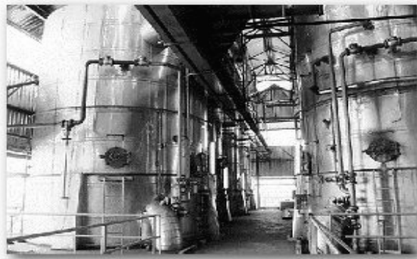
Figura 3. Evaporadores de múltiple efecto
