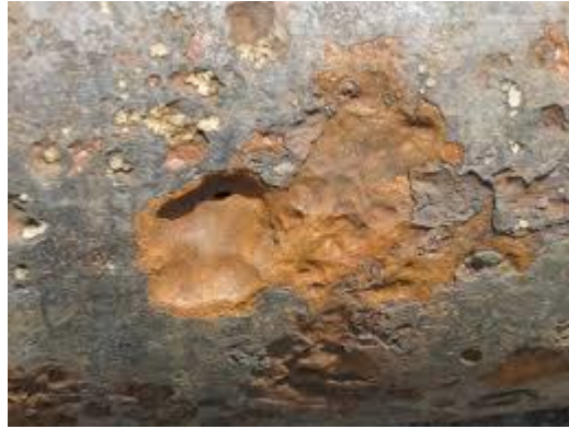
Figura 4. Corrosión por oxígeno
