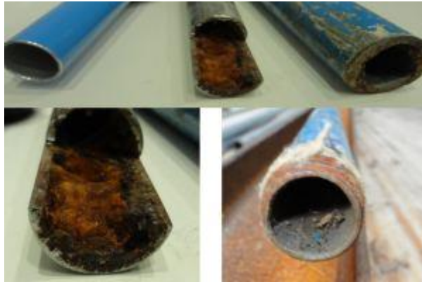
Figura 2. Obstrucción en tuberías
