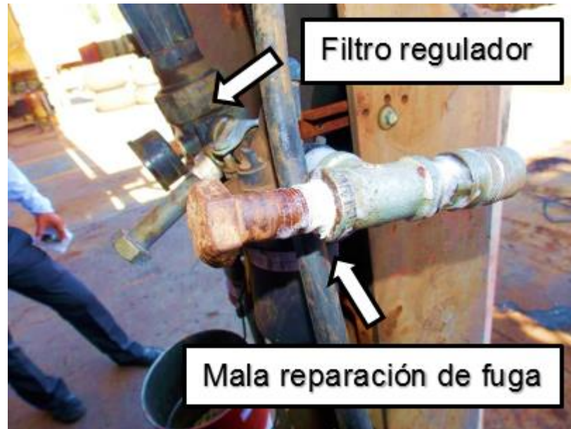
Figura 22. Mala reparación de fuga
