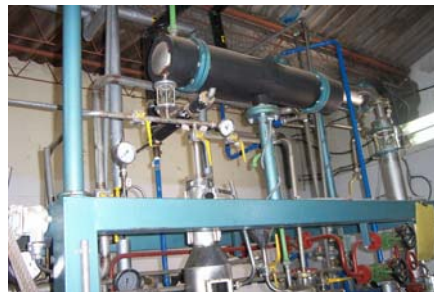
Figura 23. Intercambiador de calor
