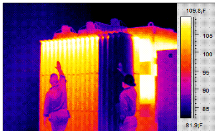
Figura 14. Radiadores con problemas de circulación de aceite
