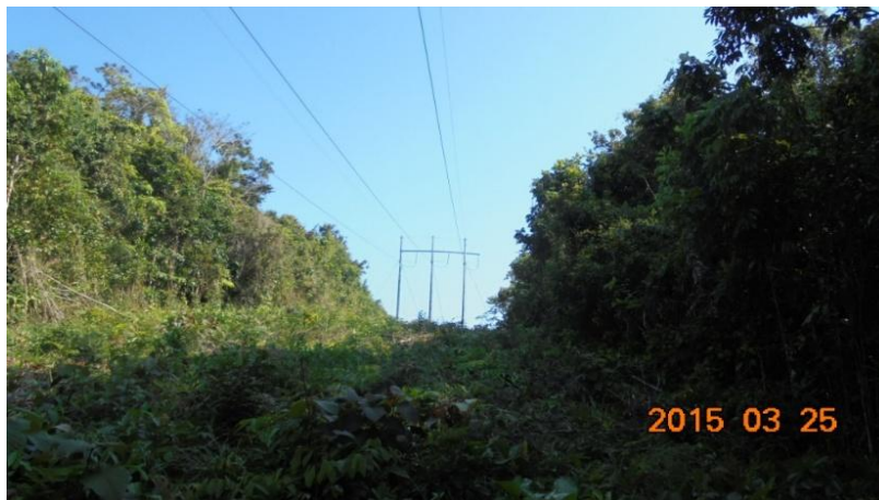
Figura 31. Brecha en una línea de transmisión de 69kV.
