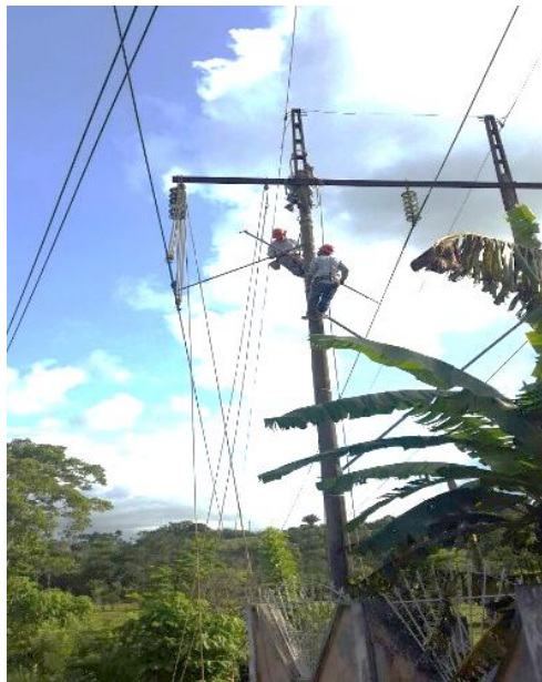
Figura 26. Daño en el herraje que sujeta el conductor con los aisladores
