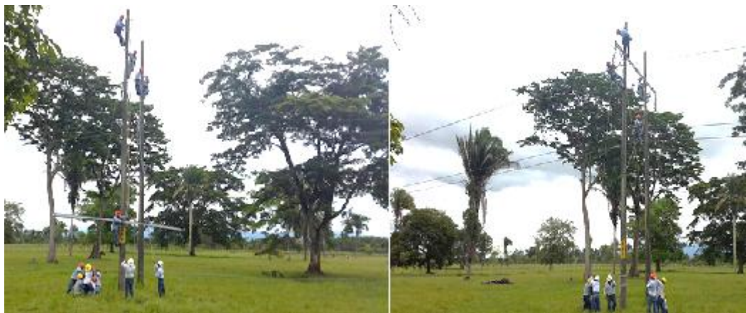
Figura 22. Cambio de crucero y tornillería
