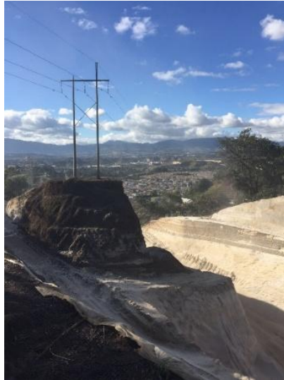
Figura 25. Estructura en riesgo por construcción de carretera
