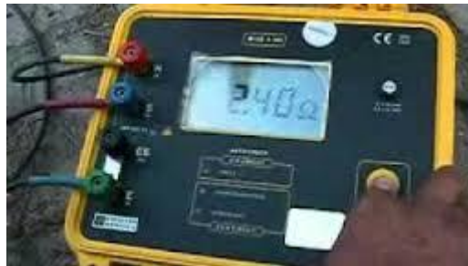
Figura 48. Medición de tierra física con telurómetro
