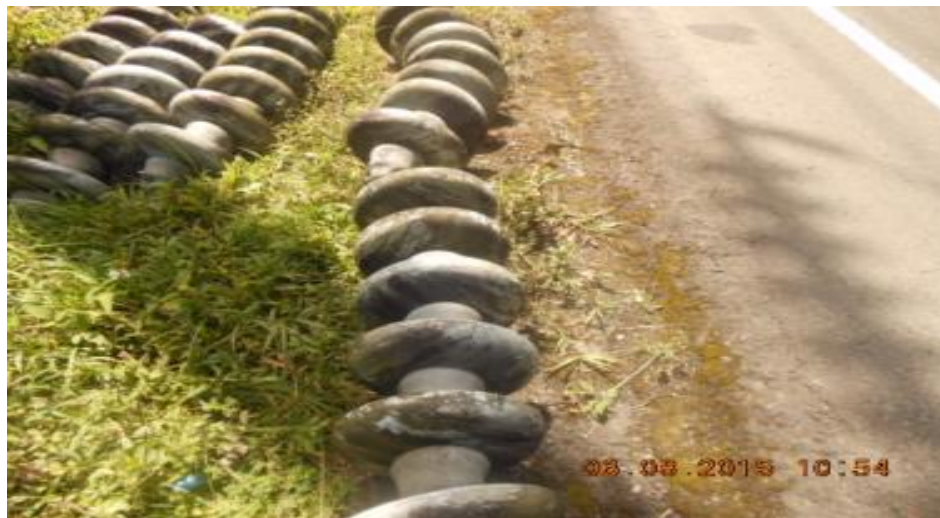
Figura 33. Aisladores defectuosos y los otros se encuentran sucios
