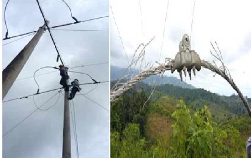
Figura 27. Daño en el conductor
