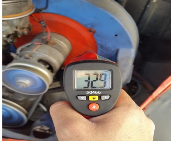
Figura 34. Temperatura base de ventilador de enfriamiento
