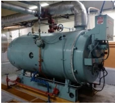
Figura 6. Caldera pirotubular de 50 HP
