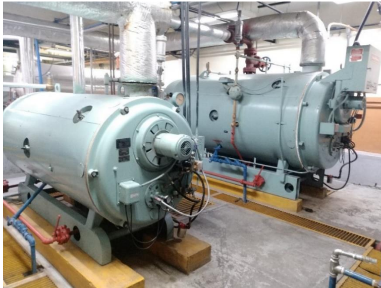
Figura 4. Cuarto de calderas
