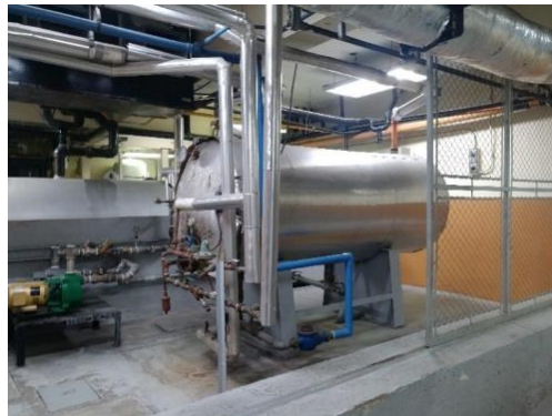
Figura 11. Intercambiador de calor
