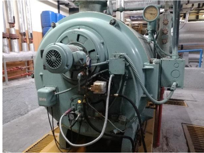
Figura 5. Caldera pirotubular de 30 HP
