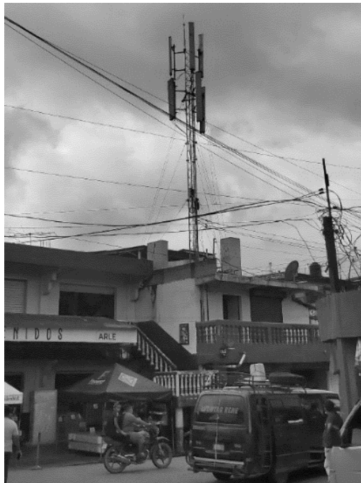
Figura 4. Torre arriostrada en Guatemala
